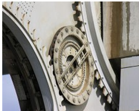
Nahaufnahme Hauptantriebsrad und obere Gondel
